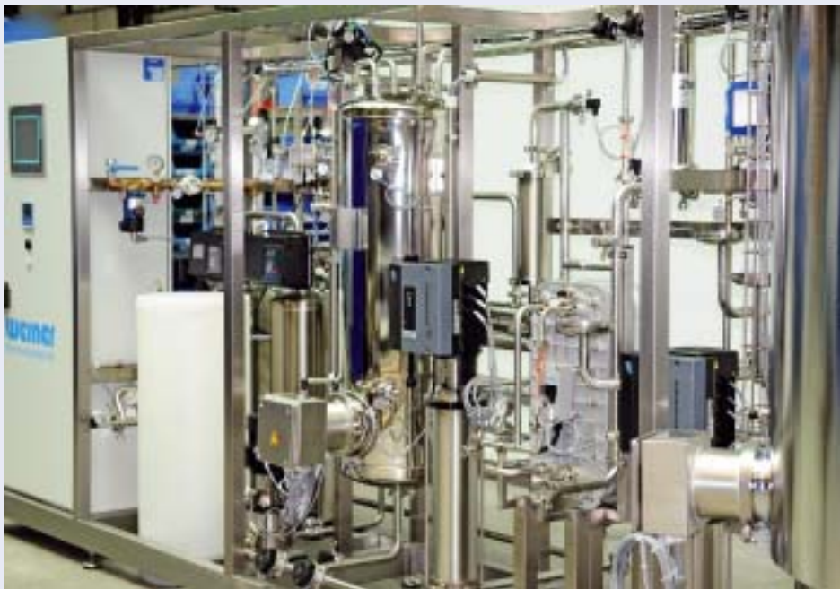
Gesamtansicht der Anlage zur Erzeugung von HPW-Wasser
