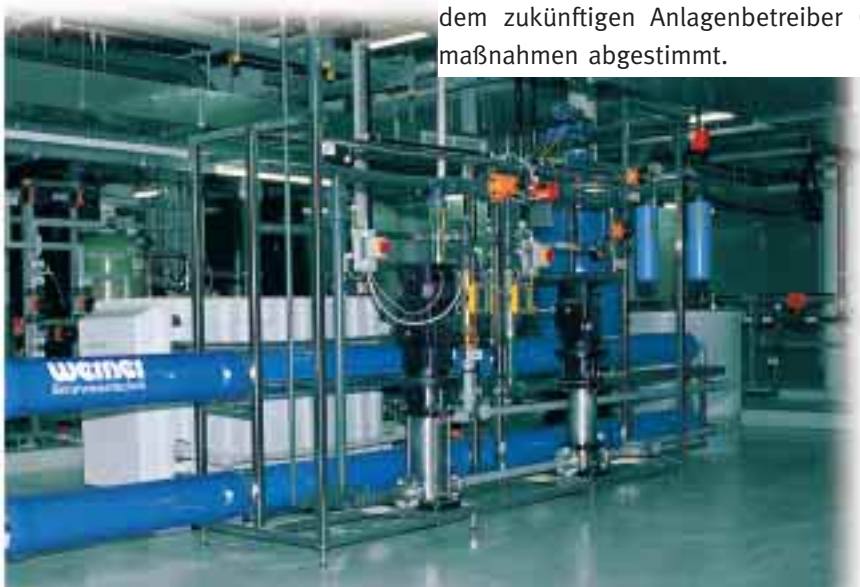
WERNER Reverse Osmose Anlage für die Mikro- elektronik, 12.000 l/h
