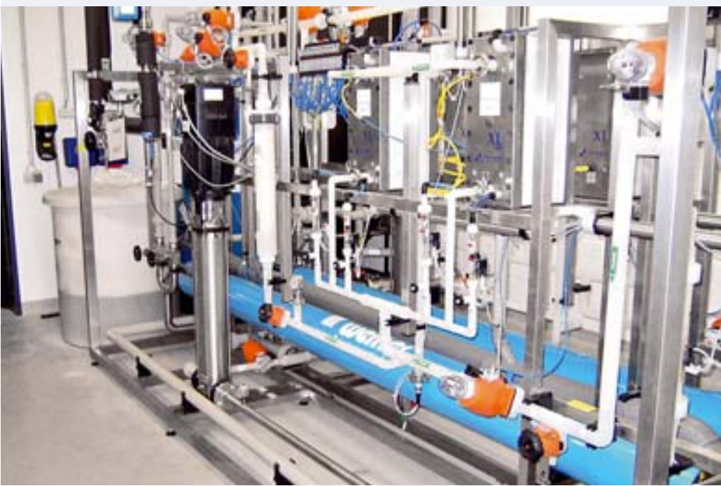
PW-Erzeugung 5600 l/h mit PVDF-Verrohrung
