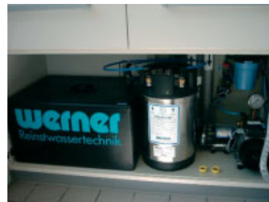
Abb. 2: Exakte Planung - exakte Ausführung: auf einer minimalen Fläche (einfacher Doppelunterschrank) finden alle Komponenten Platz. Das OP der Anlage ist in der Möbeltür integriert.
