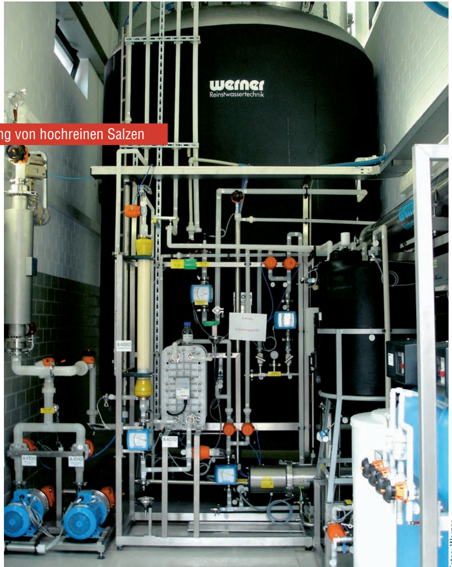
HPW-Aufbereitungsanlage mit einem Lagertank von 20 m 3 .
